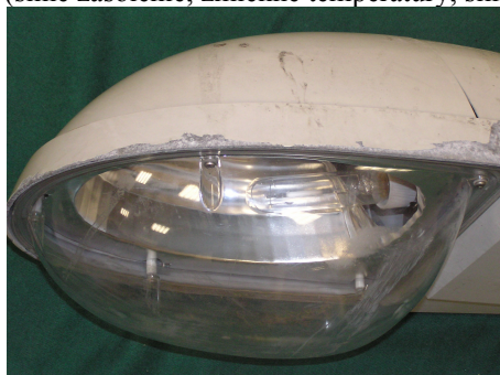
Fot.6.1 Uszkodzona powłoka oprawy.
