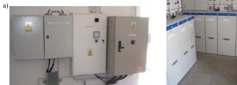
Rys. 2. Część wewnętrzna rozdzielni SN z rozdzielnicą w izolacji SF 6 :
