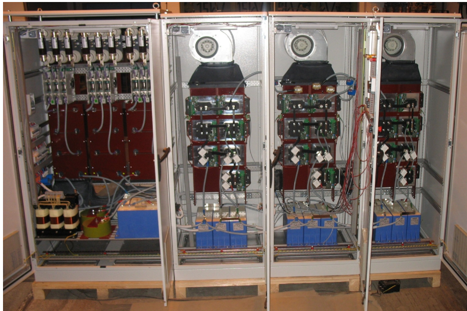
Rys.12. Aktualny stan zabudowy wewnętrznej prototypu przekształtnika 6kV/1MVA
