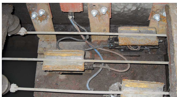
Rys. 2. Widok prądobieraków i przewodów trolejowych [4]
