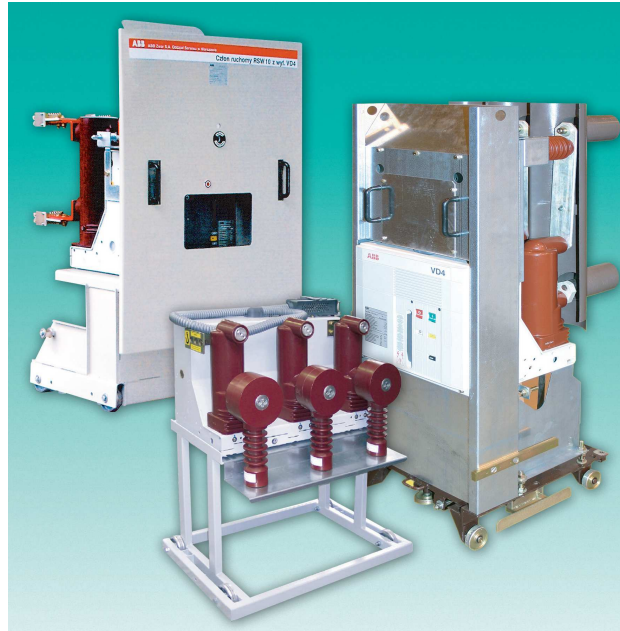
Rys. 6. Człony wysuwne rozdzielnic RSW 10, RD 1 oraz wyłącznik stacjonarny przystosowany do zastąpienia aparatu małoolejowego z wyzwalaczami pierwotnymi
