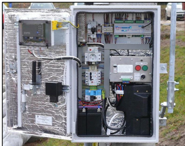
Rys. 6. Widok napędu rozłącznika wraz z urządzeniami do telesterowania i telesygnalizacji, w którym zmiana położenia rozłącznika następuje ruchem posuwistym ciężna. Źródło: [26].
