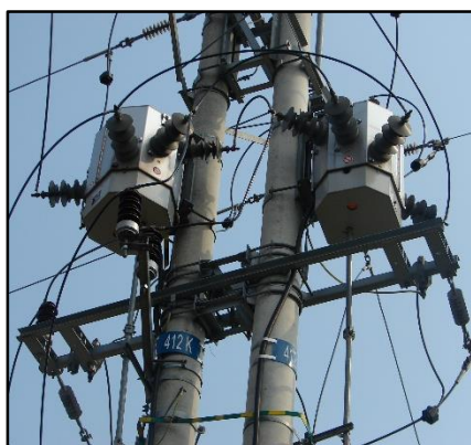
Rys. 8. Widok rozłącznika o obudowie zamkniętej z izolacji SF 6 z telesterowaniem. Źródło: [5].
