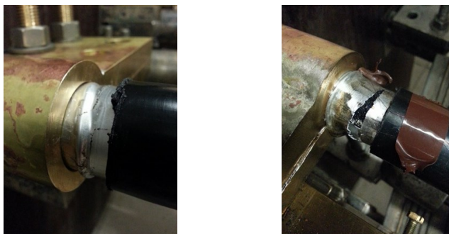
Rys.1. Odształcenia żyły powrotnej kabla Al o przekroju 48 mm 2 , widoczne po pierwszej i trzeciej próbie zwarciovej.
