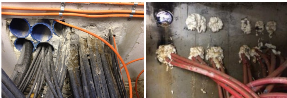
Rys.1. Wadliwe przykłady uszczelnienia.
