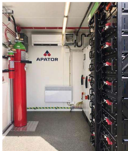
Rys.1. Magazyn energii - widok wnętrza kontenera z modułem bateryjnym, przekształtnikiem sieciowym, systemem sterująco-pomiarowym EMS, systemem przeciwpożarowym oraz układem ogrzewania i klimatyzacji
