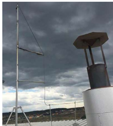
Rys.1. Wspornik dystansujący uszkodzony podczas rzeczywistego doziemnego wyładowania piorunowego w obiekt.
