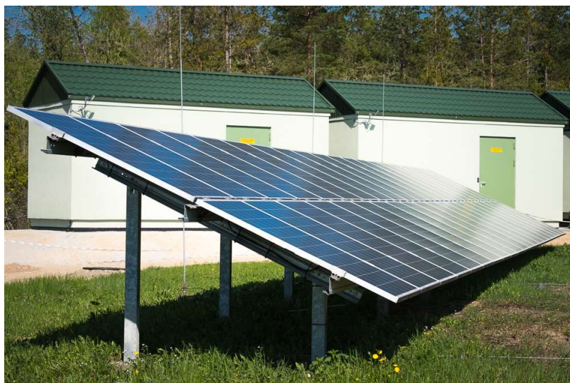
Fragment elektrowni PV Góra Żar. (Źródło własne)
