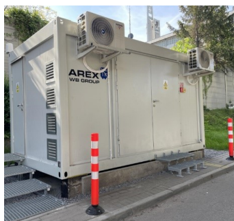
Rys.1. Kontenerowa stacja przekształtnikowa PVT-01.
