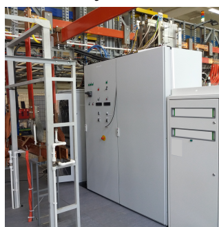
Rys. 2. Widok instalacji zmodernizowanego zasilacza na obiekcie i przykładowe wyniki badań eksperymentalnych zsynchronizowanych 2 cewek
